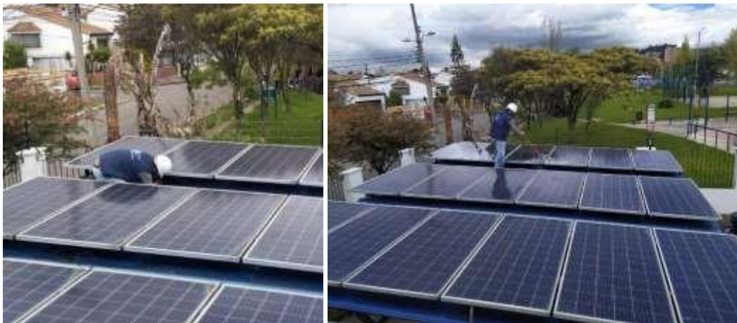
Ilustración 3 Imagen de mantenimiento Paneles Solares
